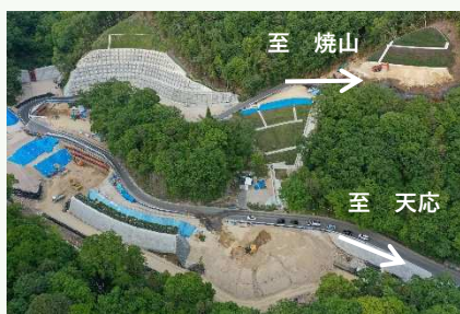
主要地方道 呉環状線 道路災害関連事業 (呉市天応町～焼山町地内)
